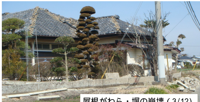
屋根がわら・塀の崩壊 (3/12)
