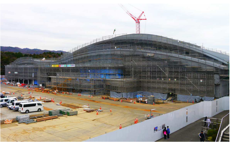
総工費約65億円(新体育館、駐車場整備費含む)で新装改築中の池の川さくらアリーナ、2015年12月23日撮影
