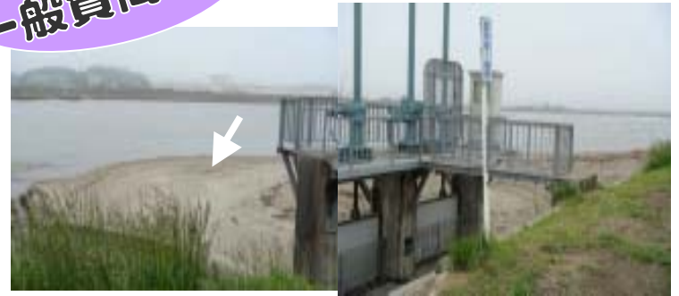
テトラポットが砂で埋没(東部排水路の排水口付近)
