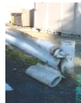
破損していたもの
