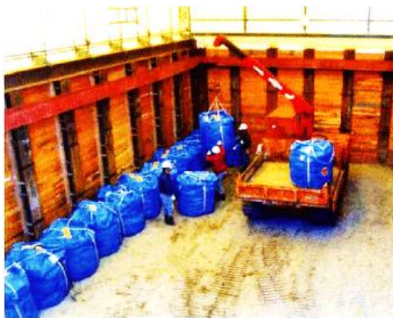
JPDR解体に伴った極低レベル放射性コンクリート(フレキシブルコンテナに収納)の砂地への素掘り埋設 -工事 95年11月~97年9月-
