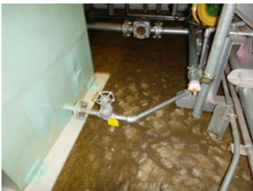
日本原子力発電東海第2原発の廃棄物処理棟の地下1階にたまった液体=2日、茨城県東海村（日本原子力発電提供）
